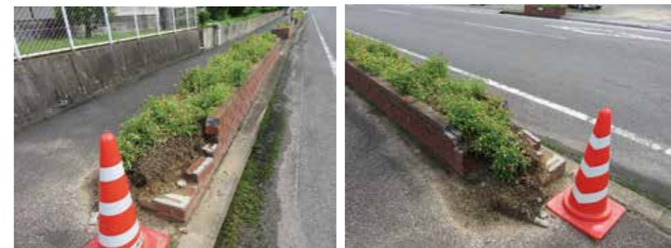
6月19日自損事故にて破損
